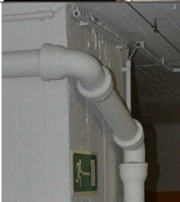
Conduites en fonte (peintes) dont les emboîtements contiennent un joint d'étanchéité plâtreux mou
